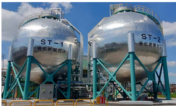
24年3月に完工したレゾナック・ガスプロダクツ川崎工場向けの液化炭酸ガス球形タンク2基。原料炭酸ガスを精製し圧縮液化したものを貯槽する
