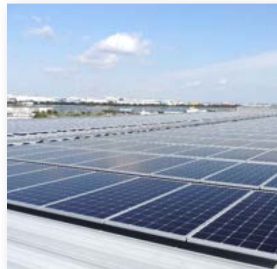
東糀谷第4発電所
